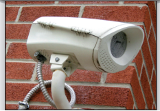
security camera cámara de seguridad
